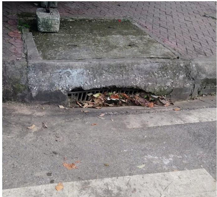
Ảnh 25: Cống thoát nước chung tại TT. Tân Uyên
